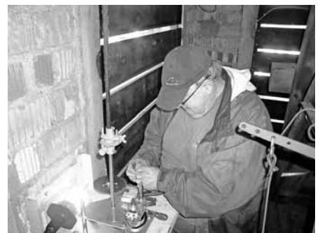
Verkabelung einer Steuerungseinheit
