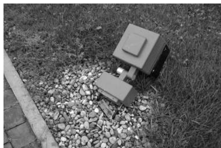
Zerstörter Strahler beim Bürgerhaus
