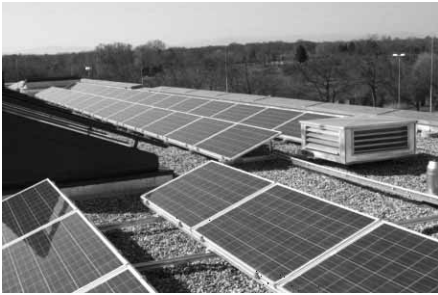
Das Dach des Bürgerhauses mit der Photovoltaikanlage
