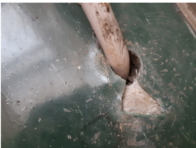
Foto 4: PVC-Bodenbelag in ehemaliger Schule am 07.03.2022
